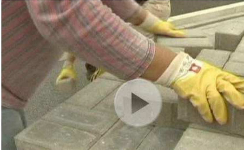
Marciapiedi con rivestimenti fotocatalitici, disegnati per ridurre il diossido di azoto (NOx) e le emissioni sulfuree derivanti dalla combustione dei carburanti.
